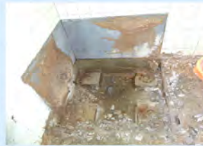
浴室内部解体(白蟻巣あり)
