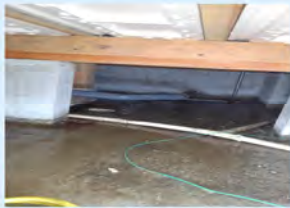
結露による床下浸水
