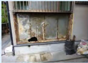
浴室壁内部結露で腐蝕解体
